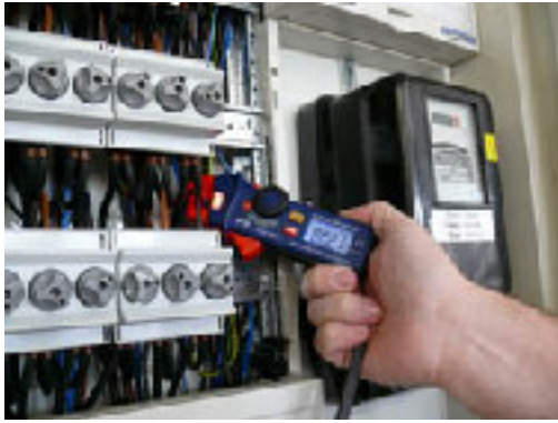
Das Ampere Messinstrument beim Einsatz im Schaltschrank
